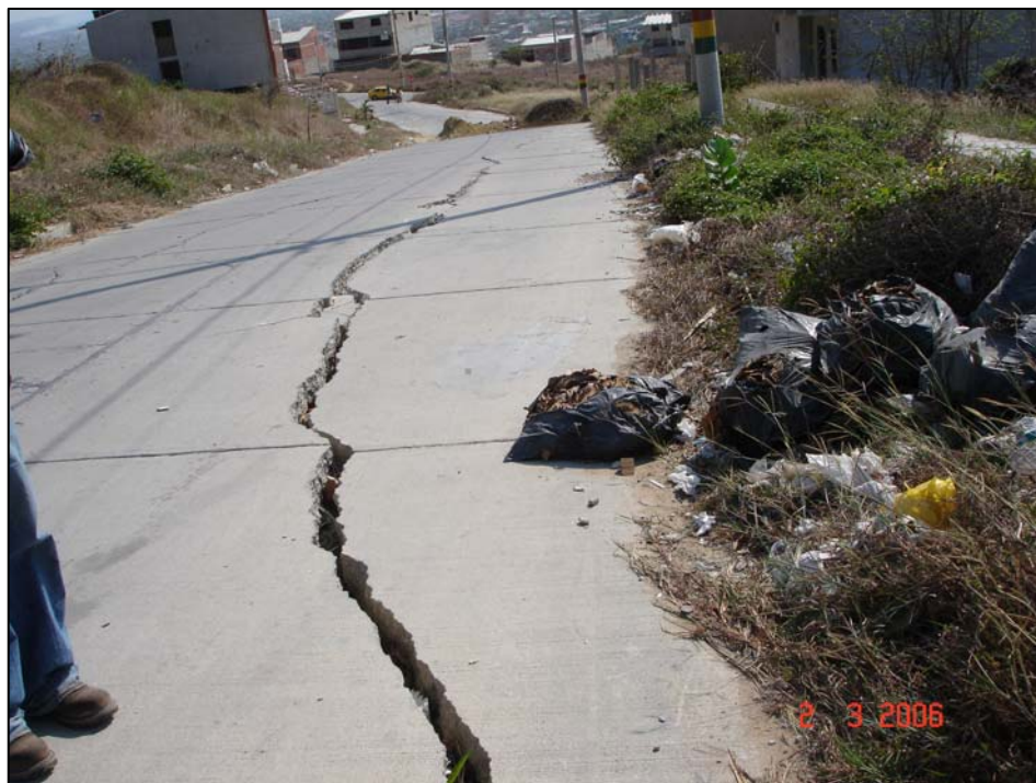
Fotografía. Agrietamientos en la corona de los taludes del barrio Campoalegre de Barranquilla.
