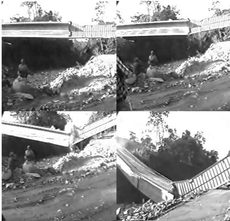
Figura 7. Etapas de la falla del puente Maizaro, en el proceso de construcción.
