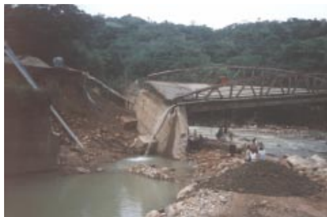
(c) Falla de estribo del Puente Unete (Casanare)
